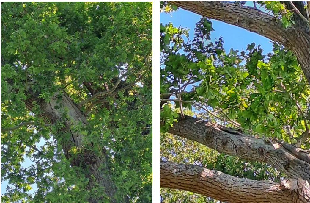
Figuur 6. Ruimte bij afgebroken tak van boom N373.01.0742 (links) en scheur in tak van boom N373.01.0758 (rechts)
