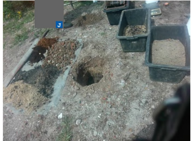
Fotonummer: 2 Omschrijving: Asbestgat 19
