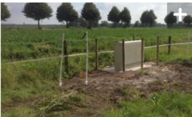
Voorbeeld van een boorgatstation in het veld. In de kast een versnellingsmeter en meetapparatuur.
