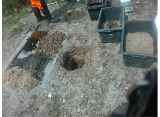
Fotonummer: 2 Omschrijving: Asbestgat 19
