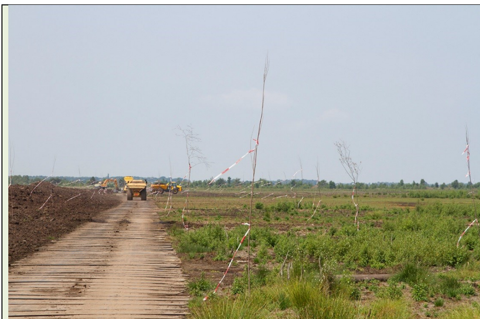
Figuur 3 Werkzaamheden aan de compartimentering in de zuidoosthoek van het Amsterdamsche Veld
