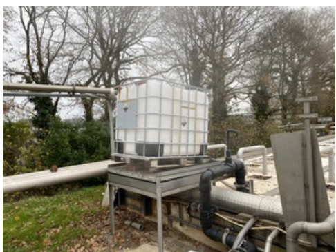
Bijlage_4_IBC_niet_boven_lekbag foto gemaakt door 5.1.2.e (RUD) op 6 december 2021 5.1.2.e op 11 februari 2022 11:56)
