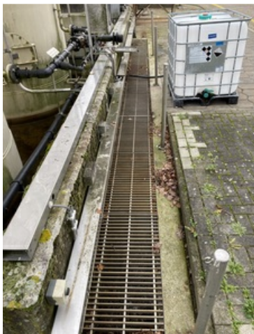
Bijlage 4 IBC_niet_boven_lekbak_2 foto gemaakt door 5.1.2.e (RUD) op 6 december 2021 5.1.2.e op 11 februari 2022 11:56)
