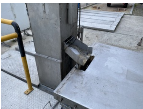
afscheider_industriële_reiniging_(residu afscheider 2) gemaakt door 5.1.2.e 21 november 2022 5.1.2.e (op 21 december 2022 17:15)
