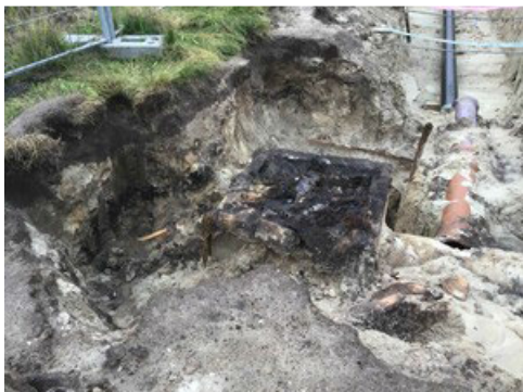
Foto d.d. 14-09-2021 gemaakt door 5.1.2.e, toezichthouder bodem RUD. Stookolie oude put: In de vierkante put zit afval, vermengd met olie. Ook hier is (links) olie te zien in het talud.
