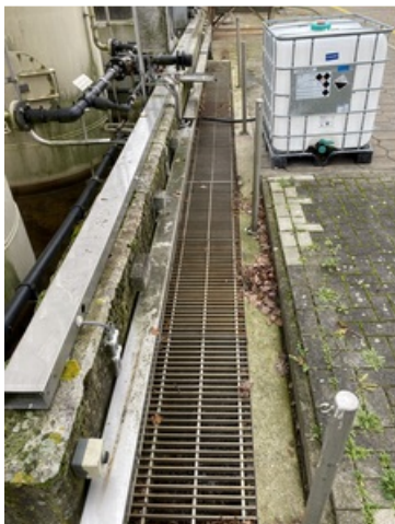
Bijlage_4_IBC_niet_boven_lekbak_2 foto gemaakt door 5.1.2.e (RUD) op 6 december 2021
