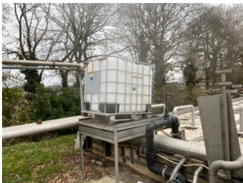
Bijlage_4_IBC_niet_boven_lekbak foto gemaakt door 5.1.2.e (RUD) op 6 december 2021
