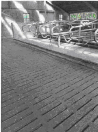
4 sept. 2020: opslag varkensmest in de kelders en roosters niet afgedekt
