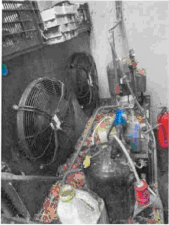
21 sept. 2023: koelinstallatie 5.1.2e (op 26 september 2023 17:11)
