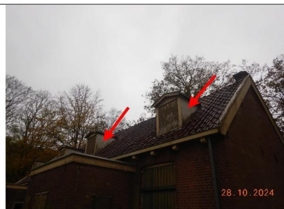
J Foto 32 | Zijkanten 'wangen' van dakkapellen
