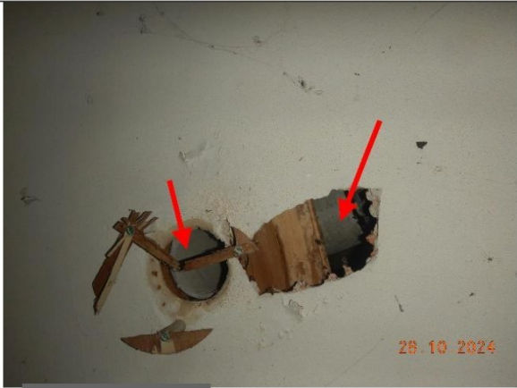
J Foto 42 | Ontluchting boven plafond
