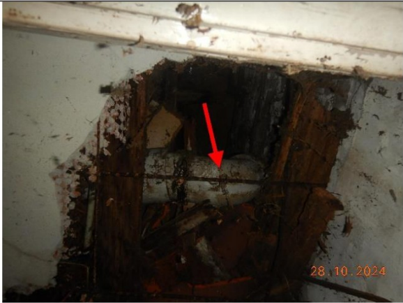
J Foto 43 | Ontluchting boven plafond
