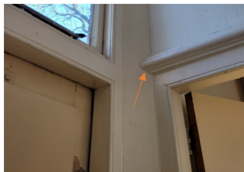
De oude kozijnstijlen in woning B. Hier mist een gedeelte van de buitenste profilering van de stijl
