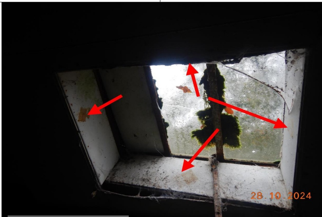
Foto 39 | Aftimmering om dakraam
