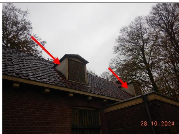
J Foto 33 | Zijkanten 'wangen' van dakkapellen
