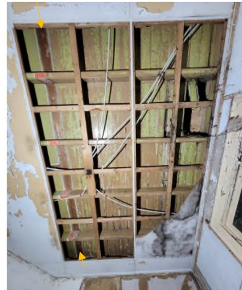
Het plafond van een van de slaapkamers in in woning E waarbij aan het kleurverschil op het plafond te zien is waar de kastenwand van de bedstede liep
