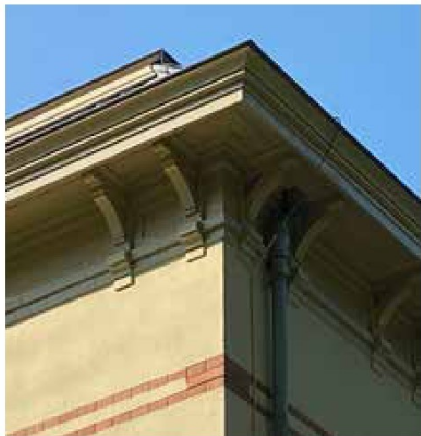
Directiehotel: rijk geornamenteerde omlopende daklijst. Gemetselde fries onder dakgoot, tussen gootklossen, is nu overgeschilderd.
