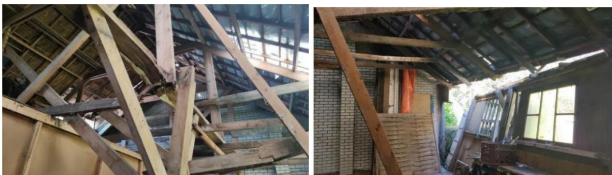
Figuur 25 Enkele voorbeelden van de slechte bouwkundige staat van de schuur
