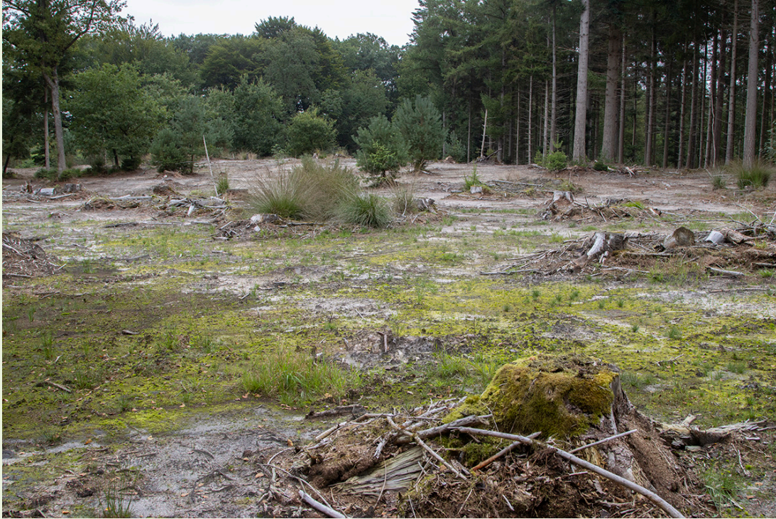
Figuur 2 Locatie waar naaldbos is verwijderd en de top laag is afgeplagd t.b.v. uitbreidingsdoelstelling vochtige heide (H4010A)
